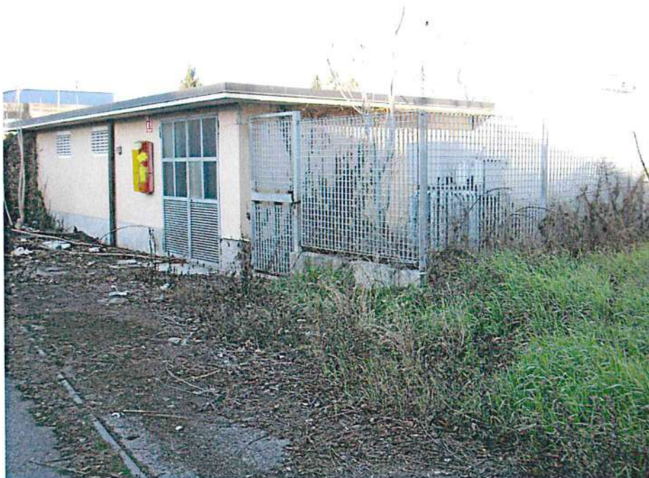
Cabina di ricevimento ENEL (4)
